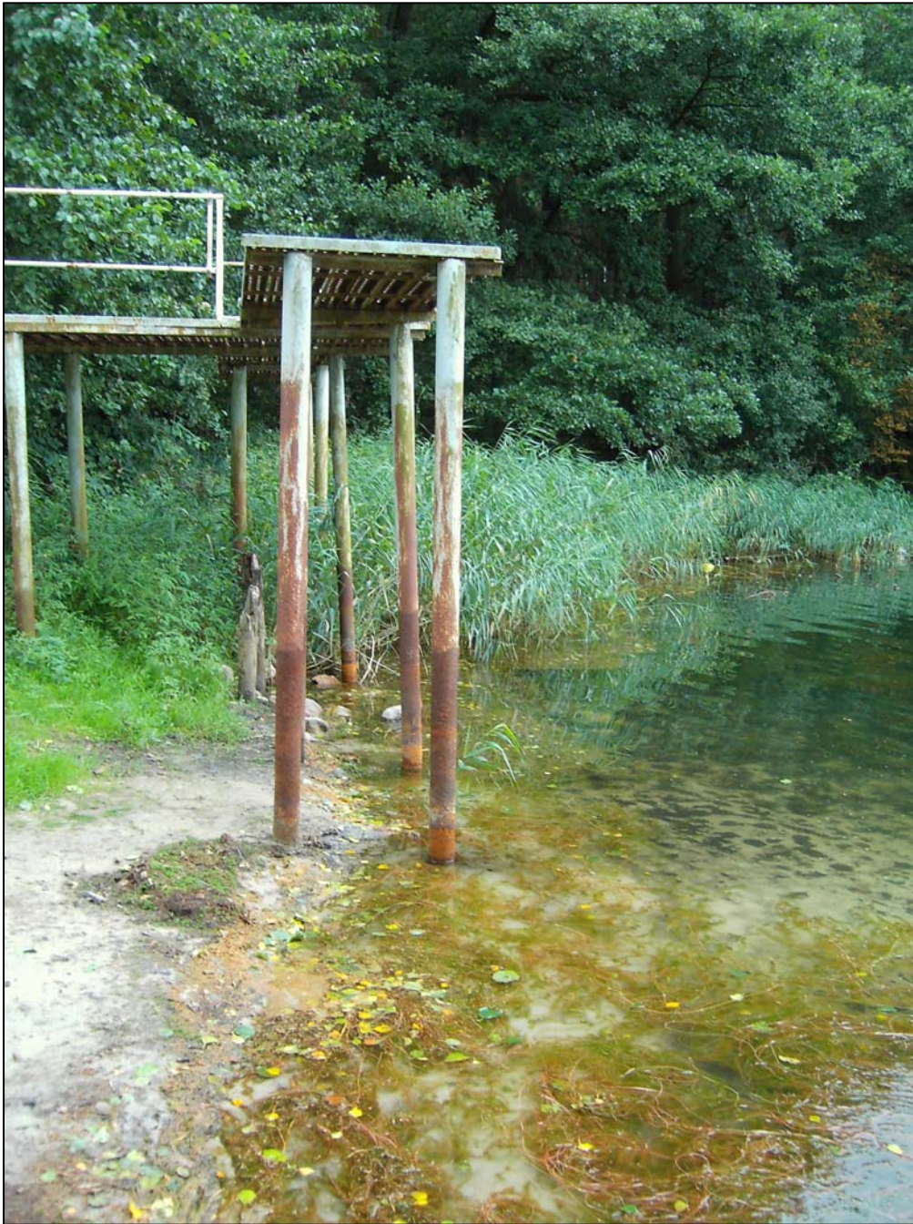
Funktionsloser Steg durch stark absinkende Grundwasserstände in Nordbrandenburg (R. Meier)
